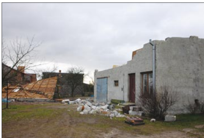
Zerwany dach z budynku przy ul. Tylickiego
